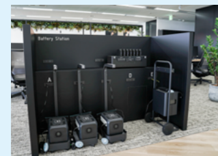
バッテリーステーション
